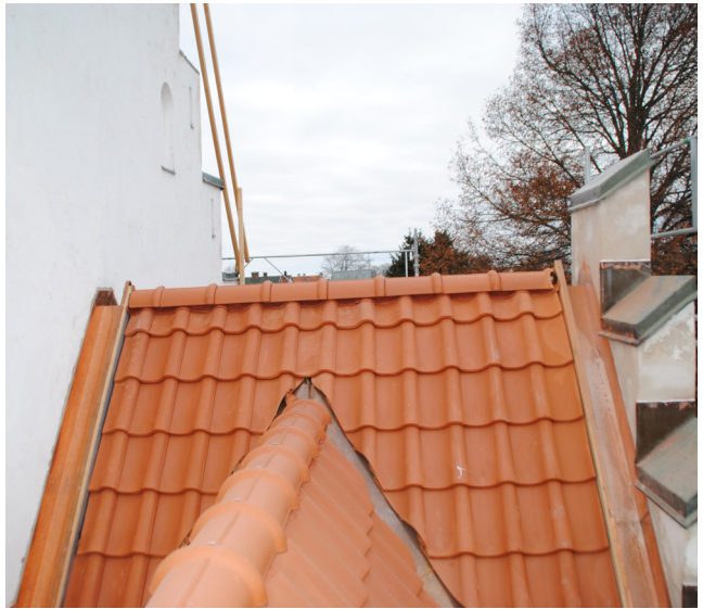
Byggnadens många takfall gör att det blir många vinkelrännor och ståndrännor. Ståndrännornas utseende har ändrats för att skydda murverket från fukt.
